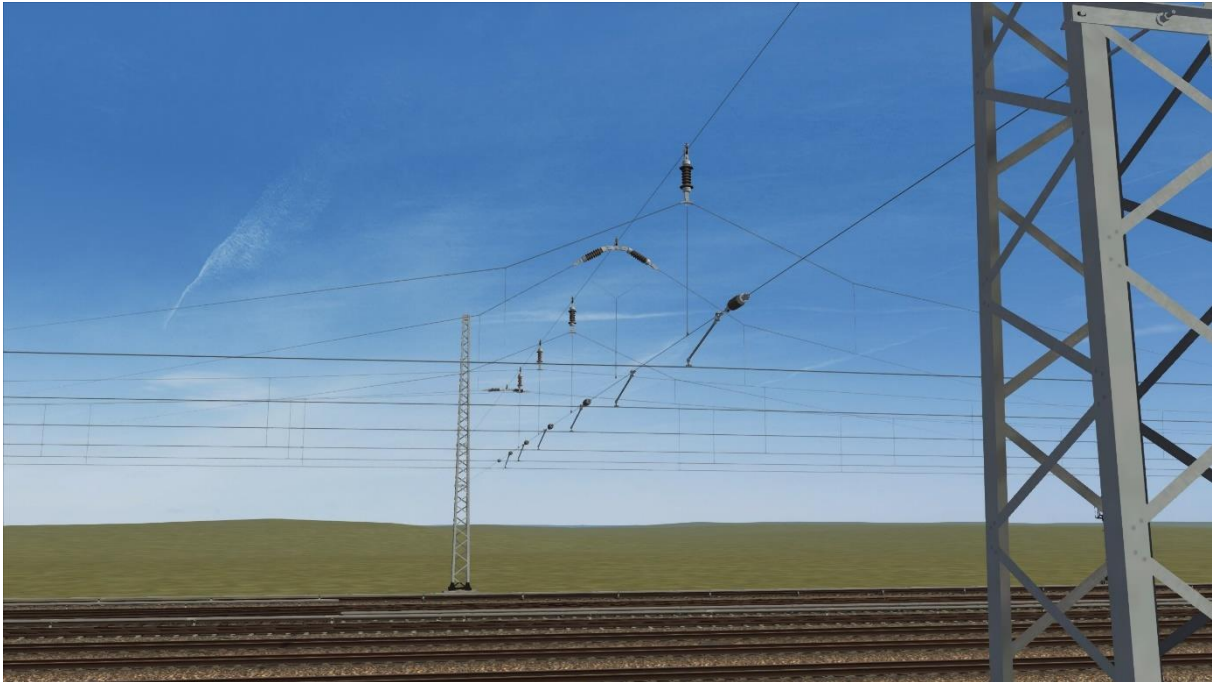
Abbildung 20 - Re1 Einfachfahrleitung im Quertragwerk
