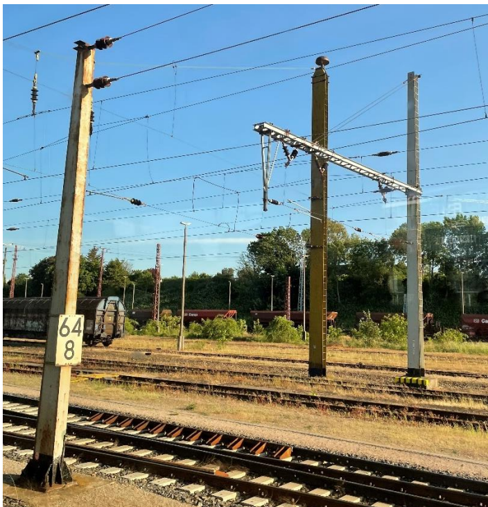
Abbildung 18 - H-Profil Masten im Bahnhof Riesa (2022)
