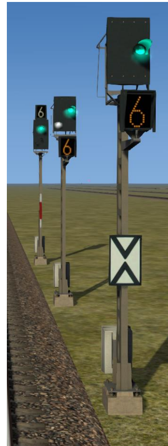
Abbildung 7 - Abfolge von Signalen mit LED Technik
